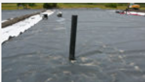
Raccordement de Geonap au droit d'un puits de biogaz sur le dôme
